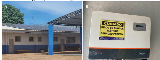
Figura 2 - Processo de instalação. (A) Local de instalação das placas fotovoltaicas na cobertura da unidade escolar; (B) Inversor fotovoltaico instalado na unidade escolar para coleta de dados referentes à geração de energia
